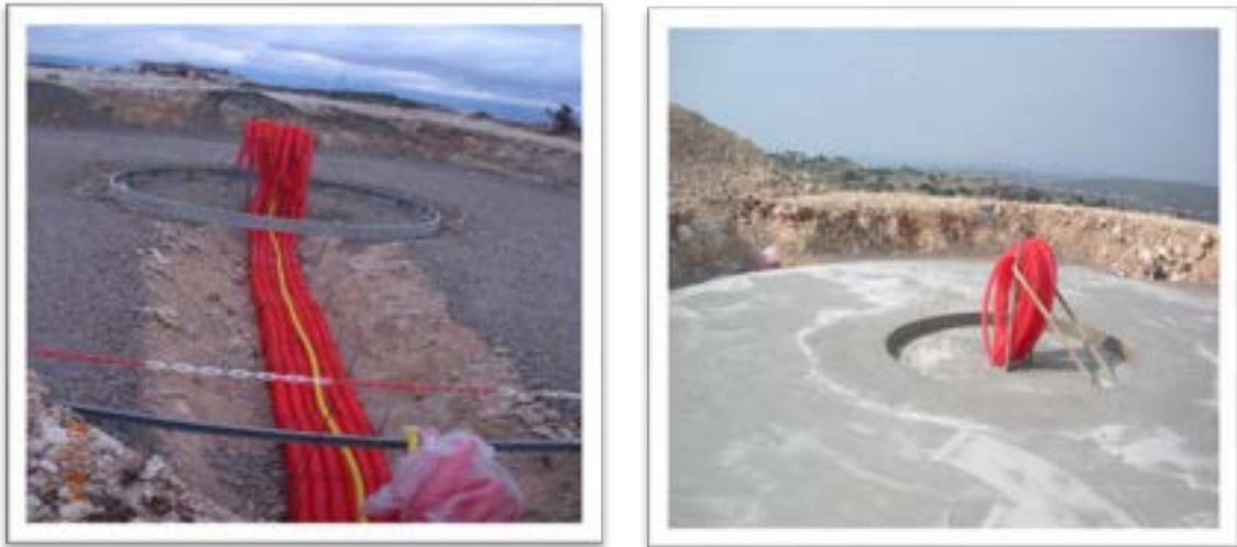
Şekil 6.8 Rüzgâr Türbini ile Step-Up Trafo Arasındaki Kablo Borusu
